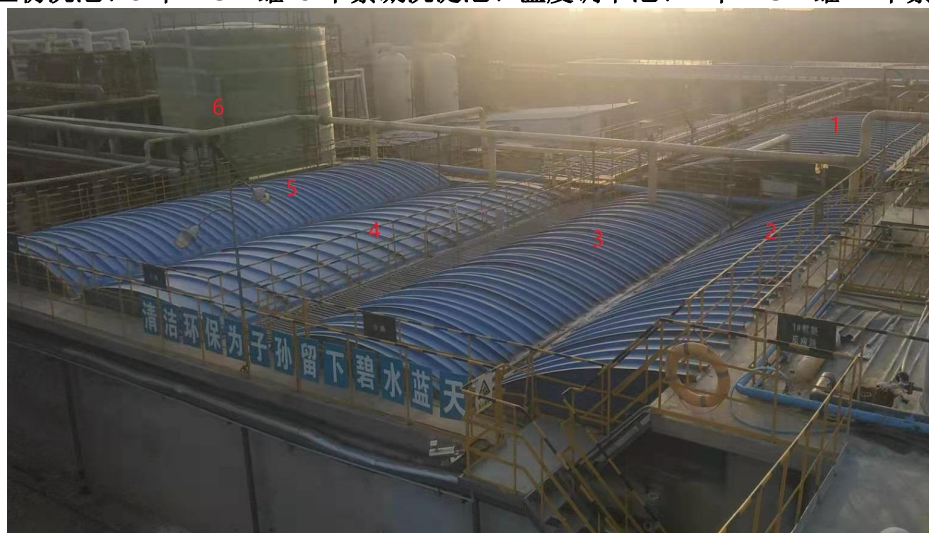
1号水解酸化池+缺氧池；2号缺氧池；3-5号、好氧池；6、UASB罐
