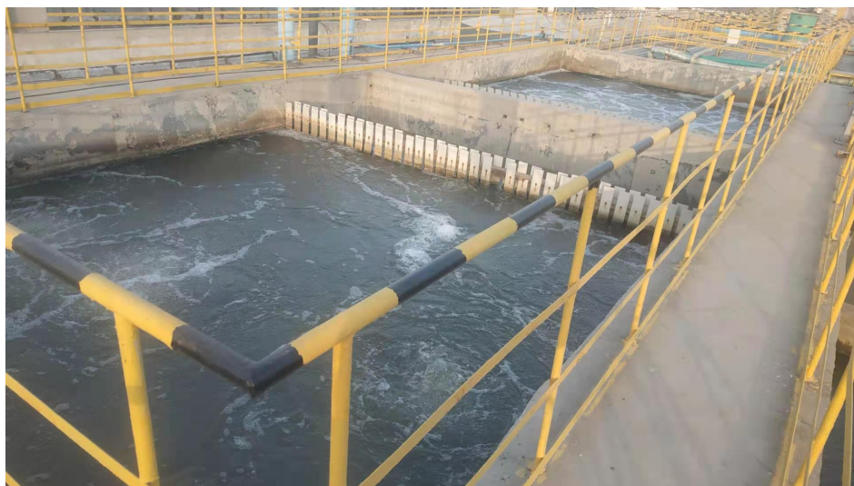
2个曝气生物滤池
