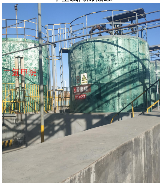
乙醇+二氯甲烷储罐
