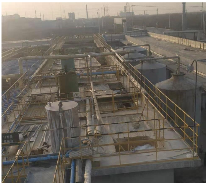
从下至上初沉池、3个HOT罐+3个絮凝沉淀池、温度调节池、1个HOT罐+1个絮凝沉淀池
